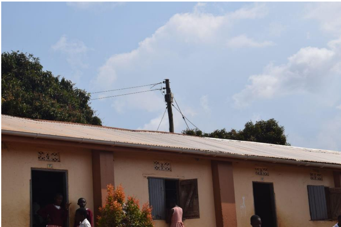
Palo installato per dotare di corrente elettrica in tutte le aule della scuola
